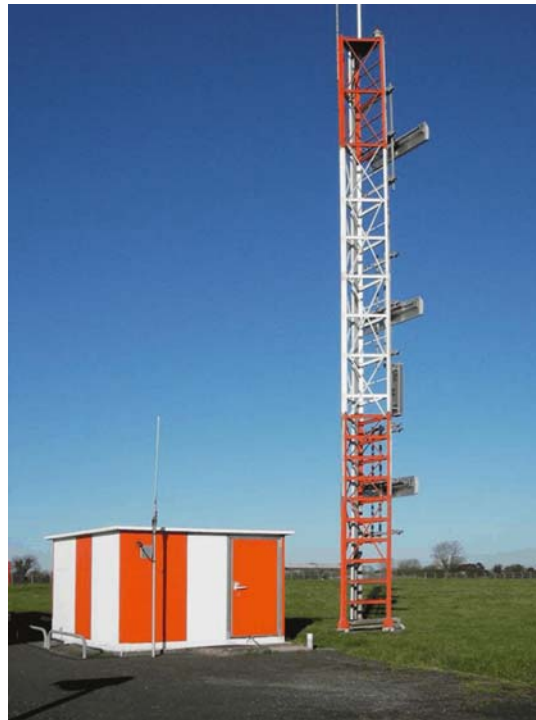
Abb. 4 Gleitweg-Antennenanordnung mit Polyester mast
